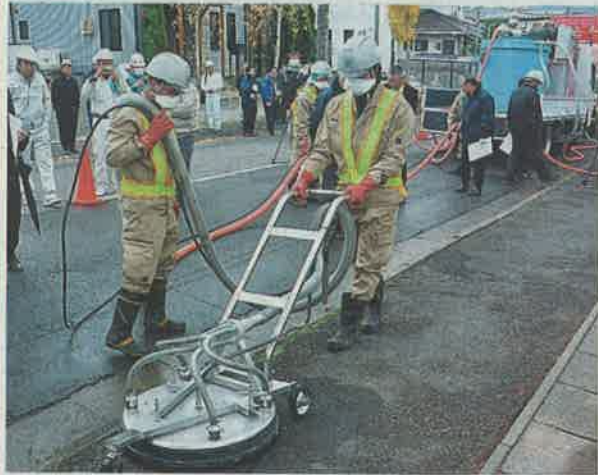
汚染水を再利用する路面洗浄装置
